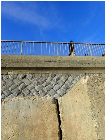
コンクリ基礎、合わせている部分 (2021年2月28日)
